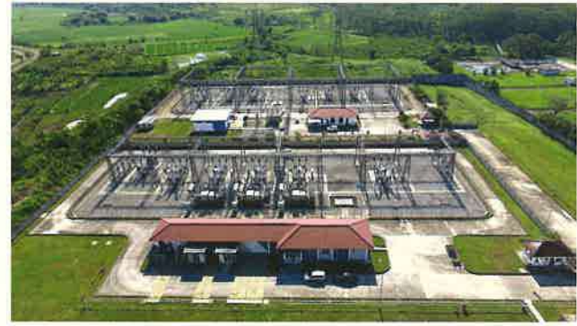
電力供給施設
