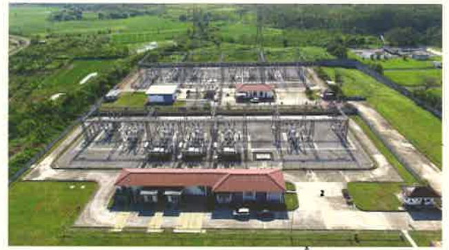
電力供給施設
