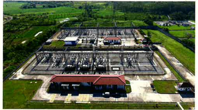
電力供給施設
