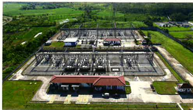
電力供給施設
