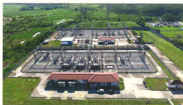
電力供給施設
